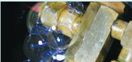
発泡液で漏えいを確認
